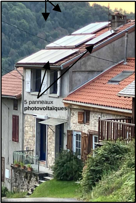
10 m², 5 panneaux solaire thermique eau chaude sanitaire et chauffage
