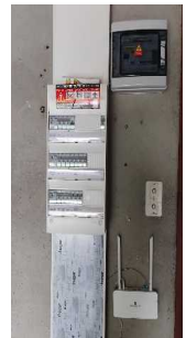
coffrets de protection courant alternatif et passerelle de communication
