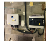
Onduleur et coffrets de protection courant alternatif (secteur) et continu (panneau photovoltaïque)00
